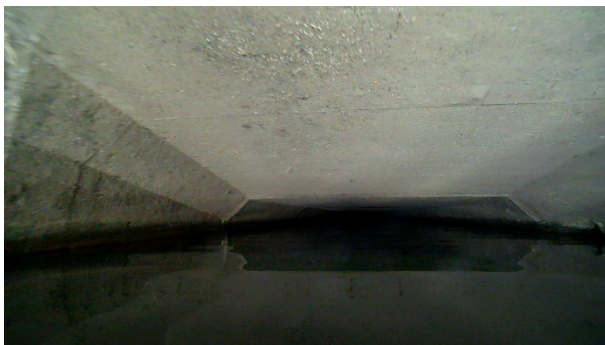
水位が高く、管と水面のすき間が狭まる管奥
